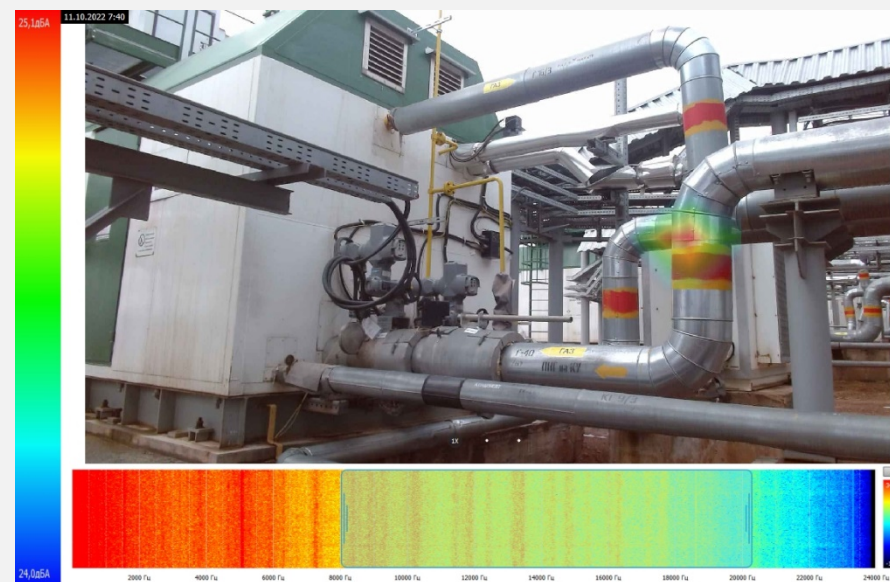
Утечка в конструкции трубопровода
